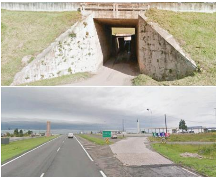
Figura 21. Acessos São Luiz do Purunã.
